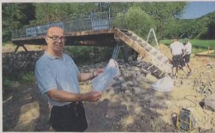
Ferdinand Schwaighöfer (links) mit den Plänen der Fußgängerbrücke, während seine Mitarbeiter das erste Treppenelement einheben.
