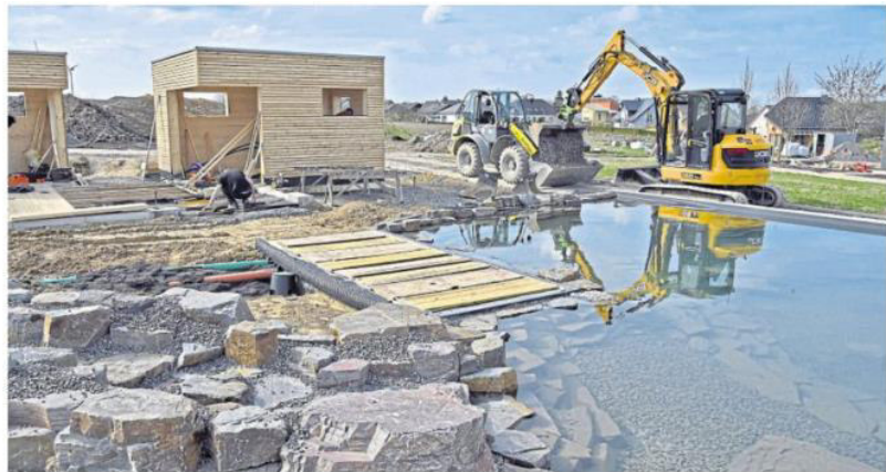
Im Lehr- und Schaugarten werden mehr als 200 überwiegend heimische Pflanzenarten mit der Erläuterung ihrer Wirkung auf Mensch und Tier vorgestellt. Die Besucher sollen hier die Vielfalt der Pflanzen unmittelbar erfahren. Die Bauarbeiten dazu sind mittlerweile abgeschlossen. Fotos: Werner Dupuis
