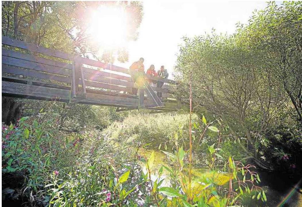
Nur 13 Jahre hielt die Holzbrücke über den Hahnenbach. Jetzt hing sie durch, wurde von einem Zimmermeister in der Mitte abgestützt. Eine massive Konstruktion aus dicken Baumstämmen soll jetzt her. Allerdings sind massive Fundamente nötig, und die Anfahrt ist schwierig.
