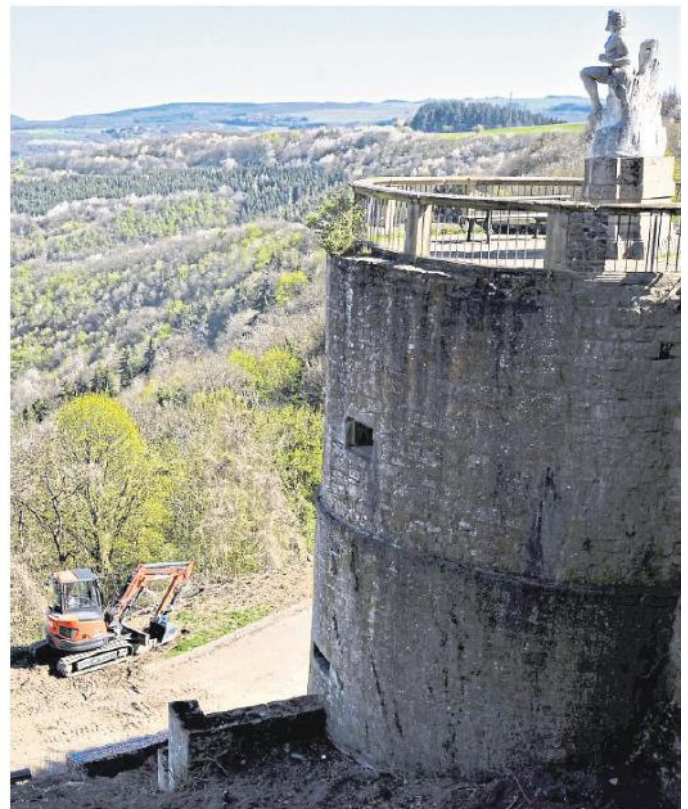
Rund um Schloss Dhaun wird derzeit emsig gearbeitet. Der Park wird mit Millionenaufwand auf Barock umgestaltet. Ein Leader-Antrag ist gestellt. Dieser wird jetzt vertagt auf 2022, auch wenn dann Konkurrenzkampf angesagt ist.
